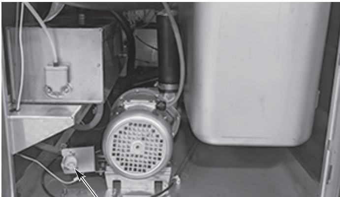
RACCORDEMENT D'EAU CHAUDE
