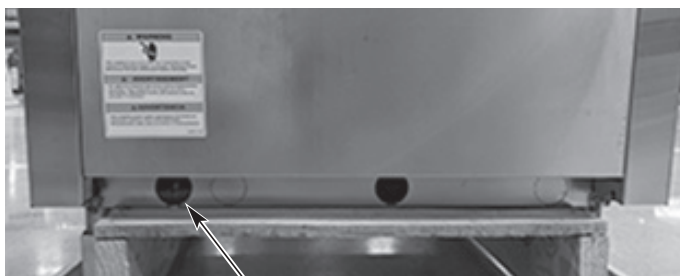
ELECTRIC CONDUIT HOLE
